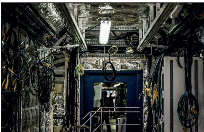
6. ábra: Több kilométer kábel biztosítja, hogy a személykocsi majd előírás szerint üzemeljen. (Forrás: Siemens Mobility)
