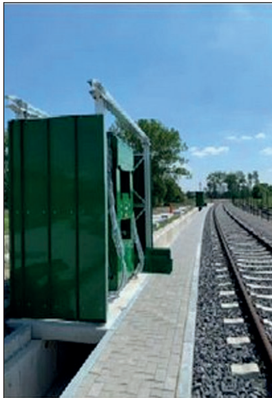
5. ábra: Hidrogén töltőállomás
