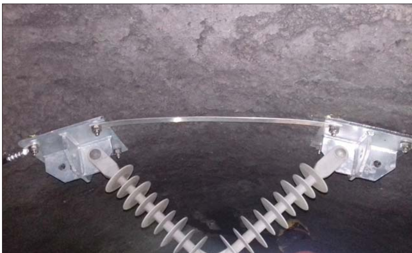
13. ábra: A piliscsabai alagútban kialakított a kettős munkavezeték felfüggesztésére szolgáló szabványos szigetős konstrukció (forrás: Szerző)
