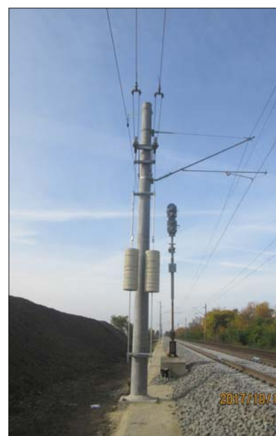
7. ábra: Feszítő és zuhanásgátló berendezés BM 20 tip. pörgetett acél-beton oszlopon.
