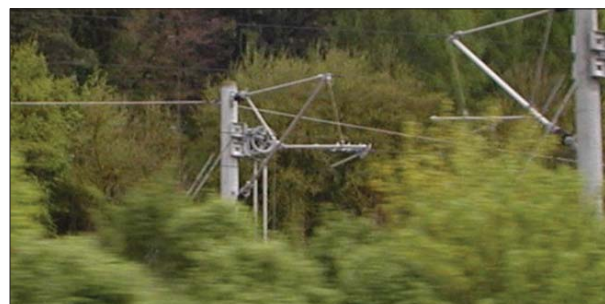
2. ábra: Vonali szakaszolás. Feszítőmű és zuhanásgátló porgetett vasbeton oszlopon (DB, Bajorország, Kinding)
