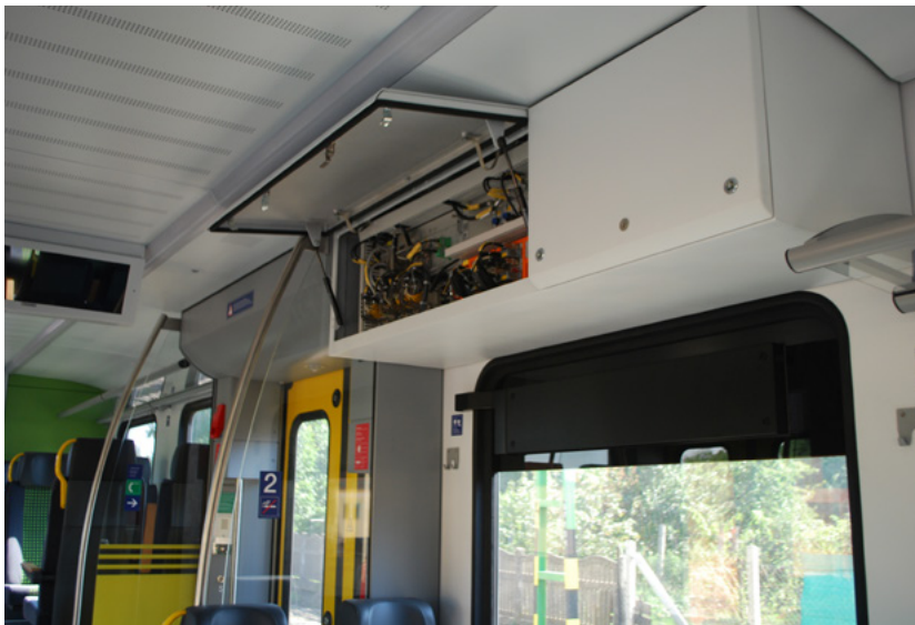
9. ábra: ETCS szekrény az utastérben lett elhelyezve (Fotó: Kovács Károly) Abb. 9.: Der im Fahrgastraum angeordnete ETCS-Schrank (Aufnahme: Kovács, Károly) Fig 9 The ETCS electric cabinet installed in the open saloon (Photo: Károly Kovács)
