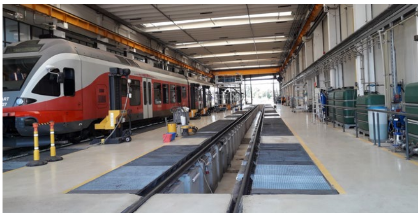
6. ábra: A kétvágányos karbantartó csarnok csoportemelőkkel, aknás vágánnyal 2020-ban (Fotó: Kovács Károly)
