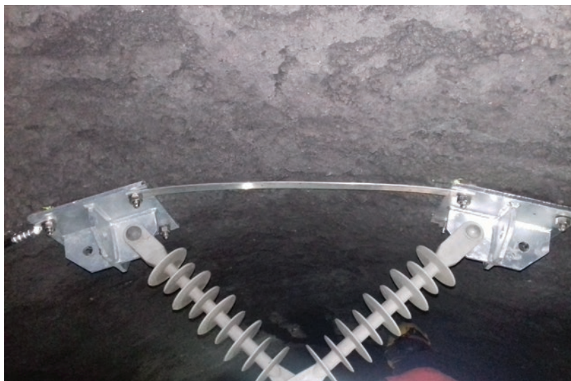
14. ábra: A pilisecsbai alagút villamos szigetelése
