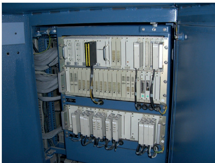
2. ábra: vezérlőkocsi elektronika ZWS-UIC-csatolóval
