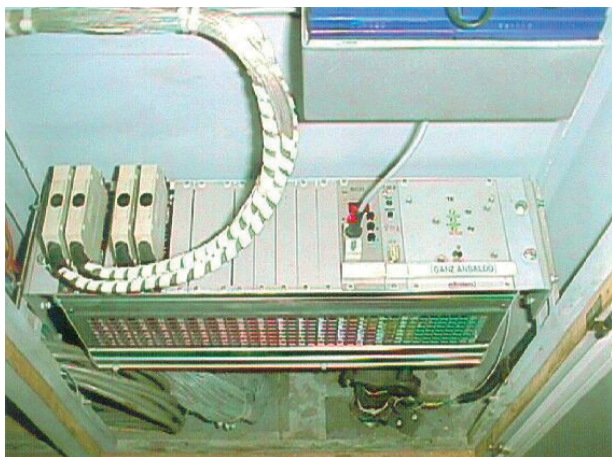
8. ábra: Járművezérlő a villamos szekrényben
