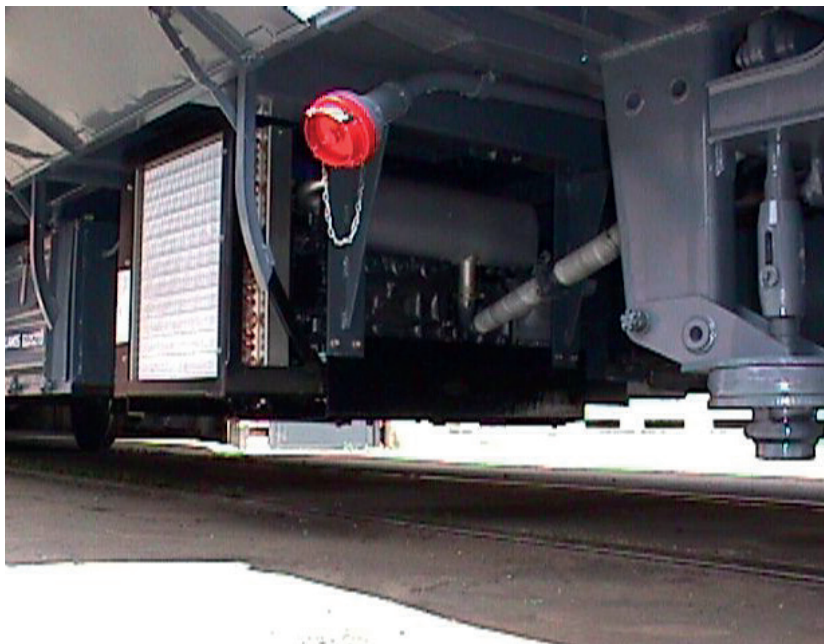
5. ábra: Az energiaellátó berendezés az alváz alatt
