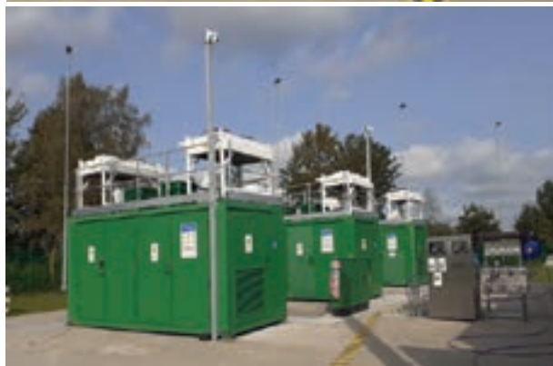
17. ábra: Hidrogén kompresszor állomás
