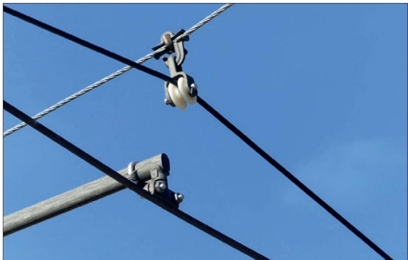
3. ábra: A városi villamos üzemet ilyen felsővezeték alatt bonyolítják le (Fotó: Murárik László)
