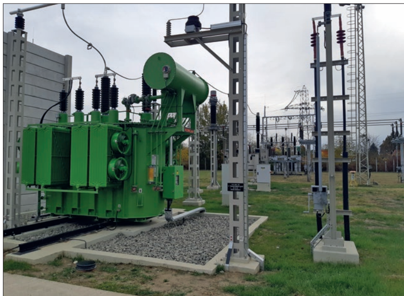
2. ábra: Érd alállomás 12 MVA teljesítményű transzformátorokat kapott
