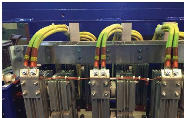
6. ábra: Erősáramú egyenirányító Рис. 6.: Выпрямительная установка силового тока Figure 6.: Heavy current rectifier
