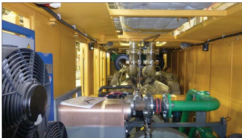
12. ábra: Motorház belső tere Рис. 12.: Дизельное отделение Figure 12.: Inner room of engine compartment
