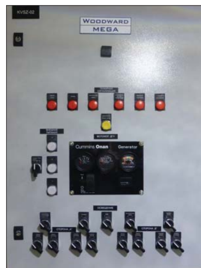
17. ábra: Mozdonyvezérlő rendszer Рuc. 17.: Щит управления локомотива Figure 17.: Locomotive control-regulation system
