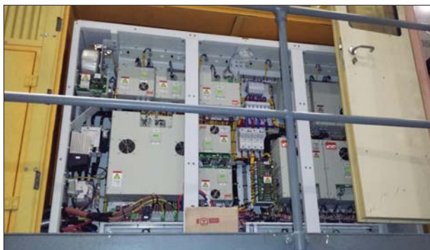
8. ábra: TEM2 mozdony segédüzemi energiaellátó rendszer Рис. 8.: Шкаф управления вспомогательного режима ТЭМ2 Figure 8.: Auxiliary power supply system of TEM2 locomotive
