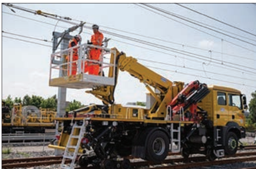
9. ábra: Kétlétű emelőkosaras felsővezeték szerelő jármű
