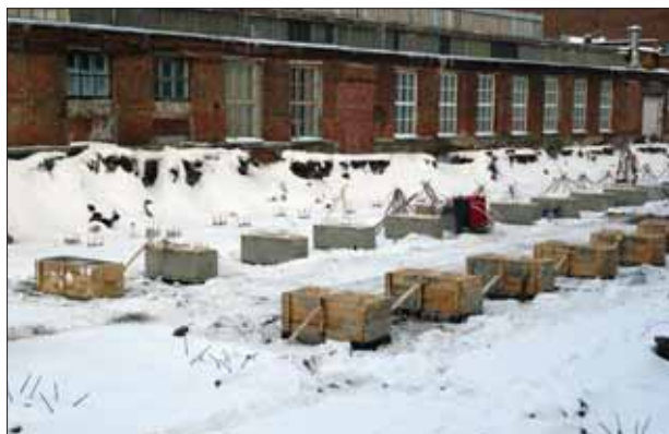
18. ábra: A tolópad pálya téli időjárási körülmények között készült látképe Fig 18: Transfer table tracks during winter
