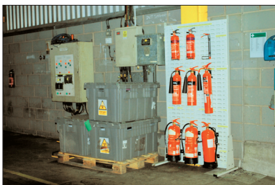
7. ábra A tűzoltó felszerelések tárolása
